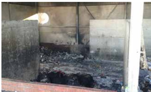
Vue intérieure du centre de tri après l'incendie
